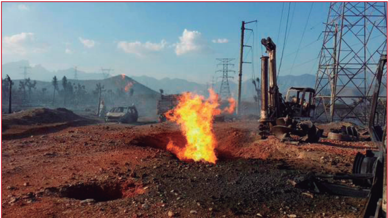
Ilustración 2.7 Accidente ocasionado por excavación cerca de oleoducto
