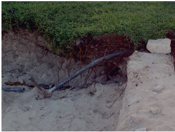
a) Ruptura de toma domiciliaria por excavación
