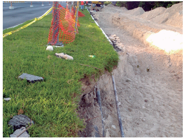
b) Ruptura de guarnición durante excavación
