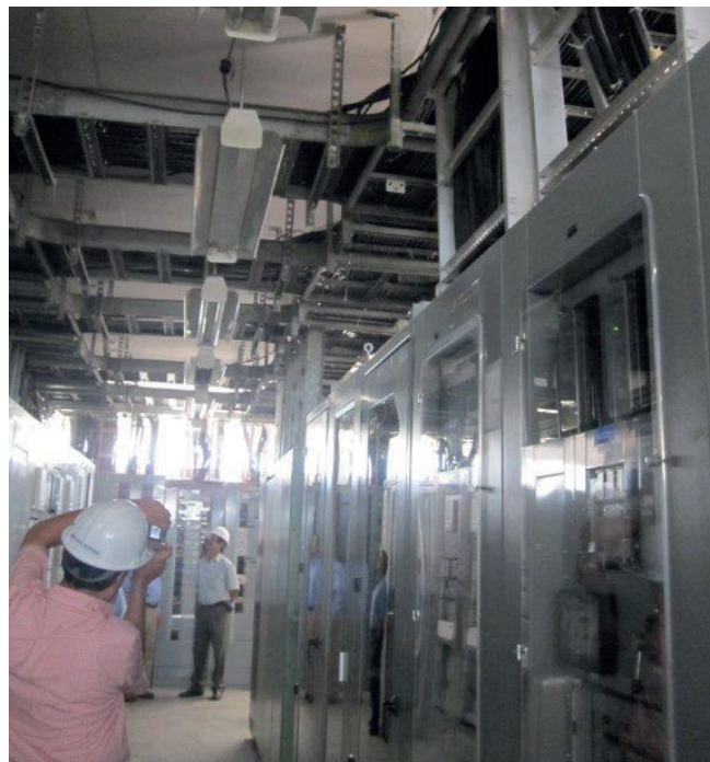
Ilustración 2.31 Tableros de media tensión
