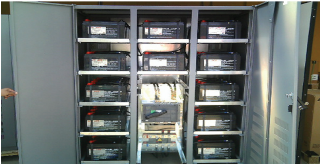
Ilustración 2.43 Banco de baterías
