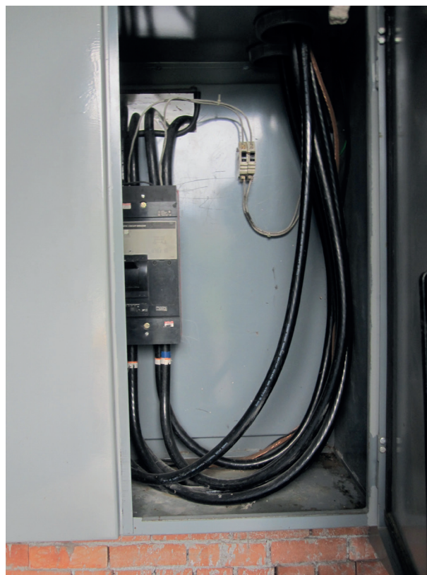
Ilustración 2.34 Conductores de interruptor principal
