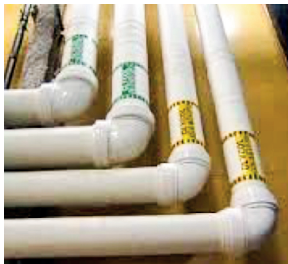
Ilustración 4.5 Tuberías de conducción
