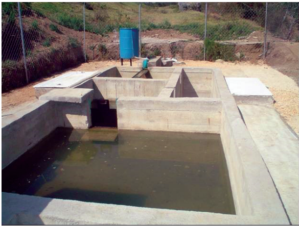
Ilustración 3.7 Filtro lento de arena en comunidad rural
