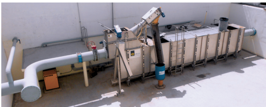
Ilustración 1.2 Rejillas automáticas de limpieza mecánica
